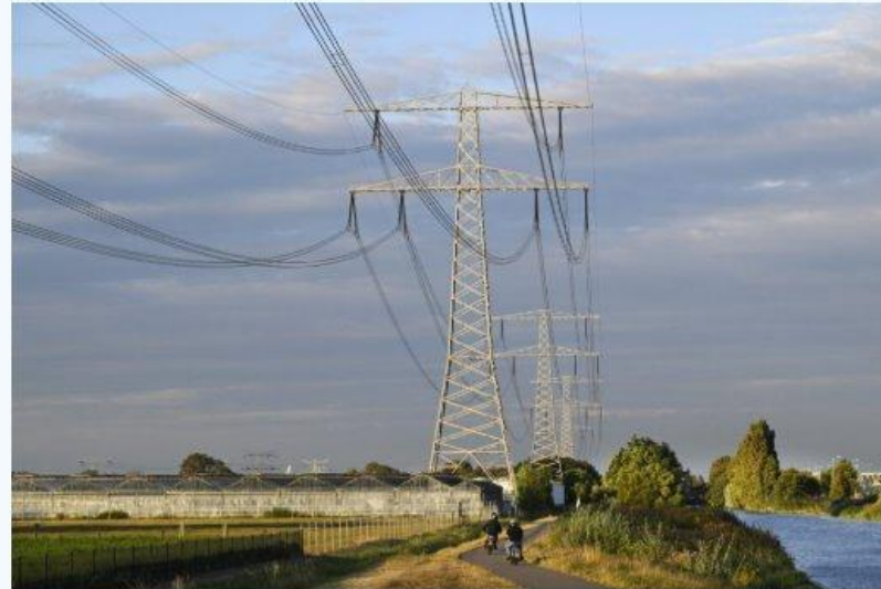
Hoogspanningsmasten in het Westland. Buiten de verbruikspieken om is er vaak genoeg transportcapaciteit op het net beschikbaar voor partijen die flexibel zijn in hun verbruik. (Foto: Peter Hiltz/ANP)
